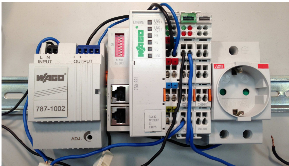
Abbildung 21 Fertig beschaltete Wago SPS
