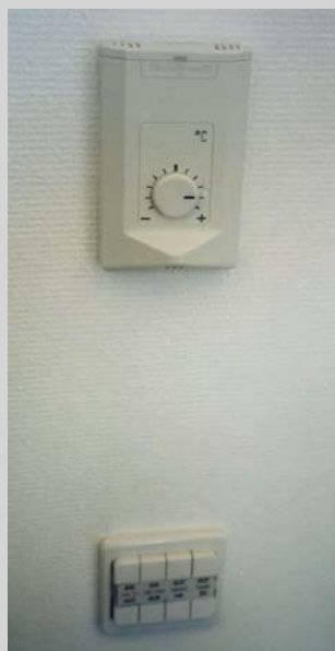
⑥ Bedienelemente (Schalter, Steller für die Zimmertemperatur)
