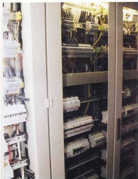
Im Keller befindet sich der Serverraum – das Gehirn des Hauses. Hier laufen die Nervenbahnen der vielen Einzelsysteme zusammen
