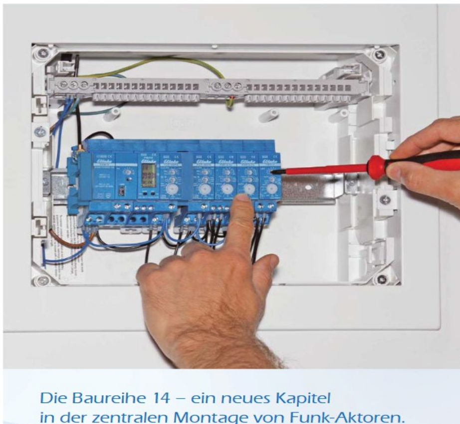
Abbildung 3: Montagebeispiel einer Gebäudeautomation mit Eltako
