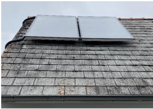
Abbildung: Solarthermie auf dem Garagendach
