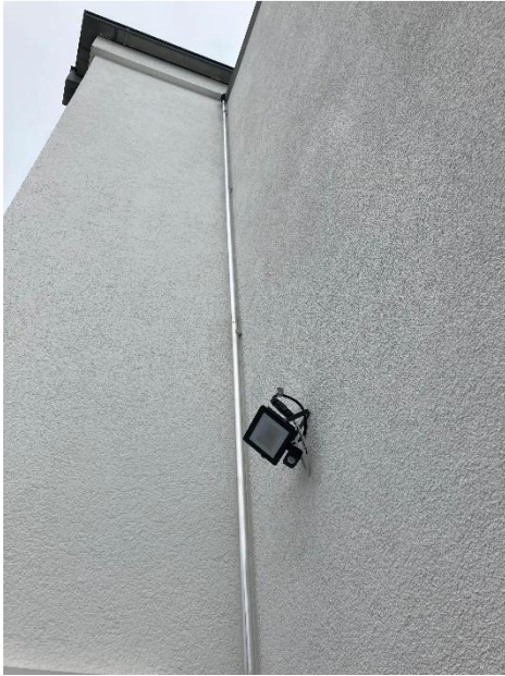
Abbildung: Leitungsführung in Panzerrohren an der Hauswand
