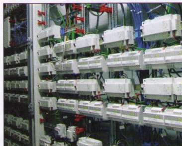
Bild 7: eibNode-Netzwerk in einem Gebäude der Liegenschaft
